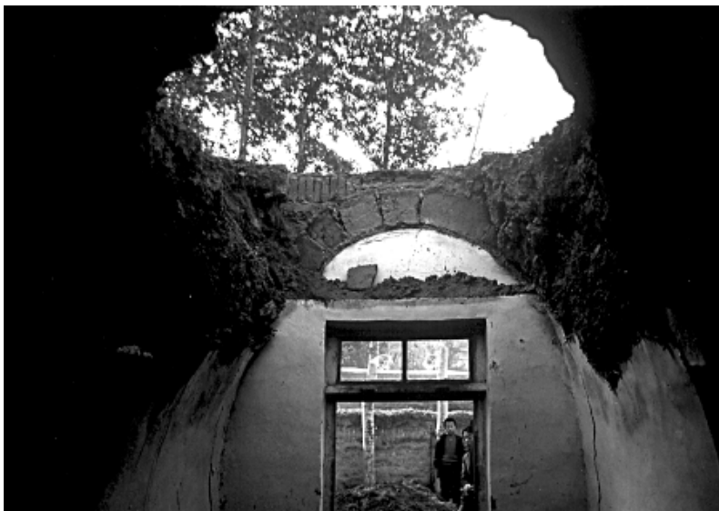
◎窑洞的屋顶和墙壁因淫雨塌落。大雨时而带来严重灾害。
